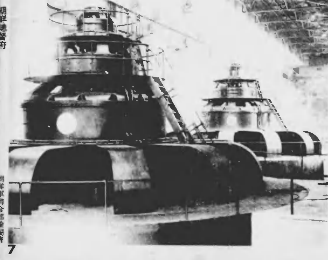
◁ 既に運轉を開始した姉妹發電機、處女發電機は、流機、二號機のみであつたが今年中には三號機も運轉開始の途である
