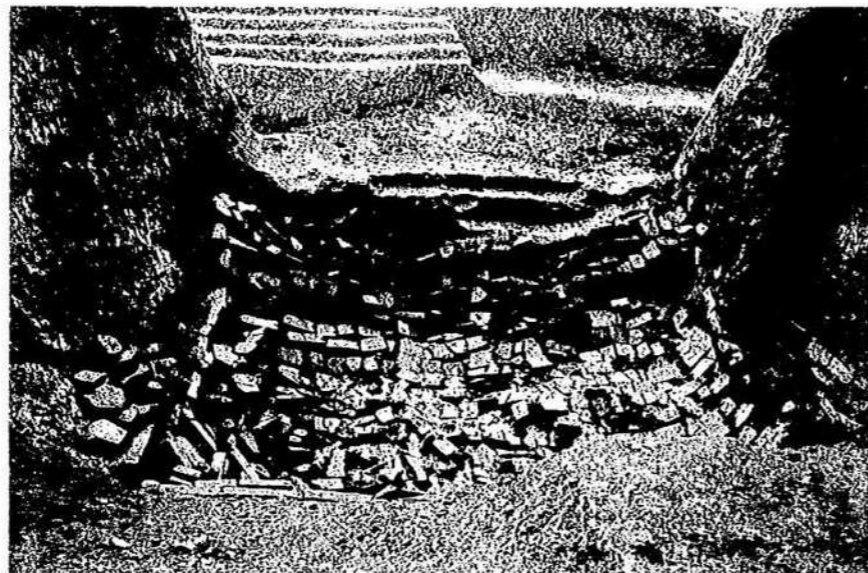
(△ 望 方北) 况状没陷非天塔填同 (八二)
