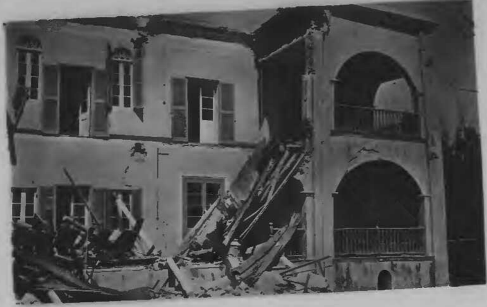
第一五圖 災害當時ノ佛國領事館 △壁体補強鉄ボルトヲ有ス 此附近ニ於テ被害ノ最大ナルモ ノナリ
